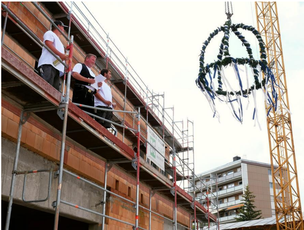
Die Flachdachabdichter übernahmen mangels Zimmerern den Richtspruch für das neue Treuchtlinger Seniorenzentrum und tranken auf das Wohl der Bauherrn und Handwerker. Foto: Viola De Geare
