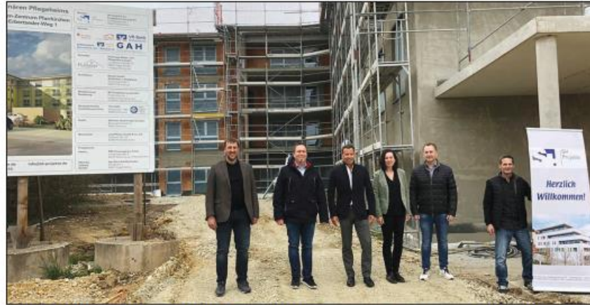
Freuen sich über den Baufortschritt (von links): Bgm. Wolfgang Beißmann, Johannes Pichlmayr, Helmut Stranzinger, Roswitha Kadletz, Edwin Guth (Geschäftsführer Pichlmayr), Reinhard Hoffmann (Projektleiter SH). - Foto: red
