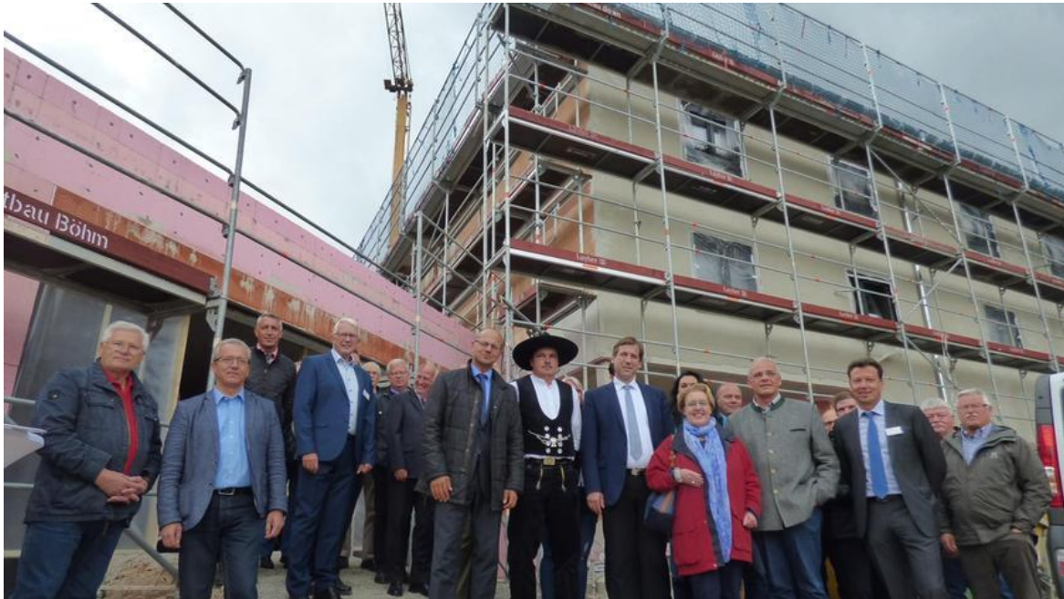
Beim Richtfest des neuen BRK-Seniorenzentrums Gößweinstein sparte Landrat Dr. Hermann Ulm nicht mit Lob. Foto: Thomas Weichert
